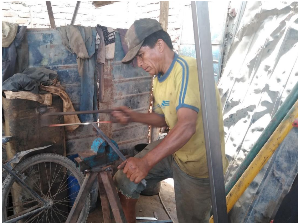
Figura N°. 1. Corte de Varillas en la Empresa Metal Mecánica “AMIGO” Fuente: propia
