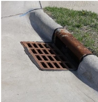
Figura 18. Rejilla En Drenaje Pluvial. Fuente: (Wikipedia, 2016)
