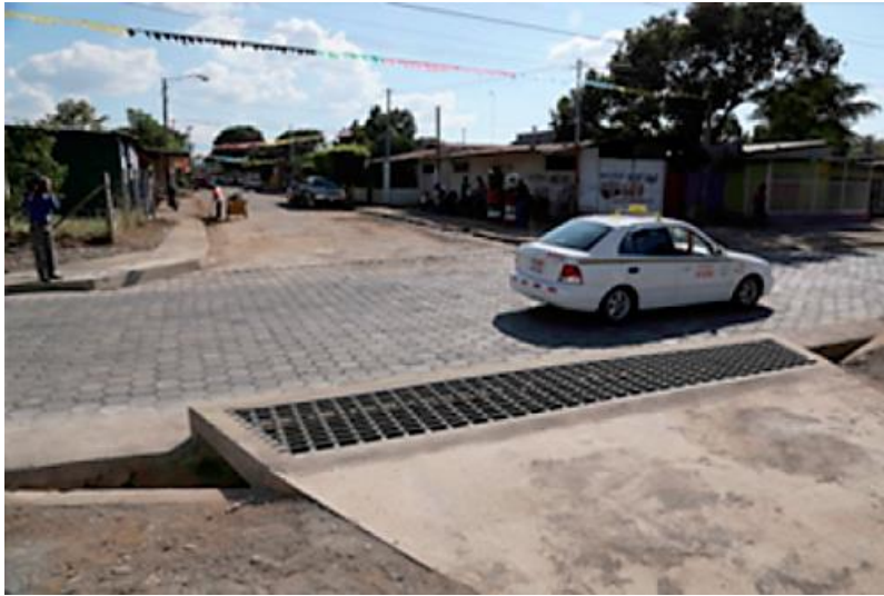
Figura 3. Sistema de Drenaje Pluvial, alcantarilla de cruce. Fuente: La voz del Sandinismo (2013)
