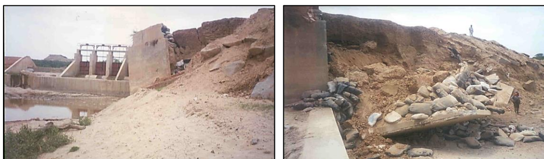
Figura 6. Colapso del muro de contención debido al fenómeno de “El Niño” - 2002. Fuente: DEPOLTI, 2003
