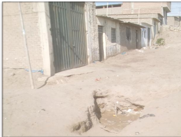
Figura 4. De las 1122 viviendas el 95.10% son construcciones de adobe, como se aprecia en la imagen, presentando un gran problema a la filtración o alguna avería en las futuras tuberías; por afectar el agua a sus construcciones.
