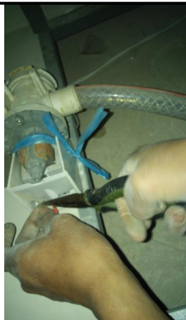
Figura 48. Instalación eléctrica para la bomba.
