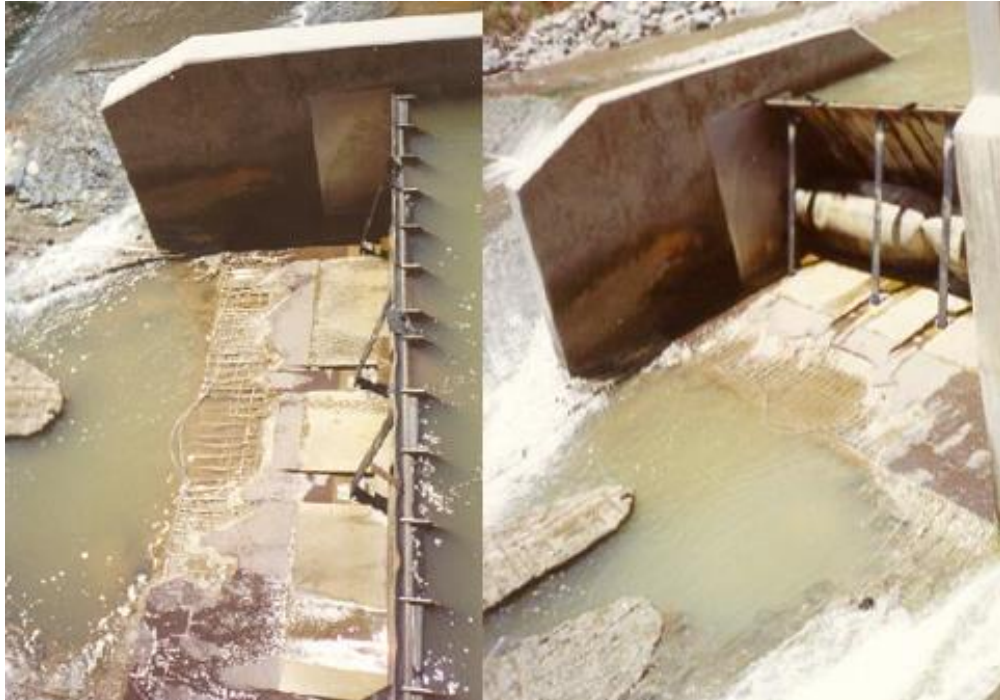
Figura 1. Erosión del concreto aguas abajo.
