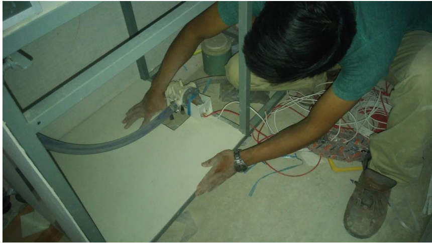
Figura 44. Bomba instalada en el taque de almacenamiento.
