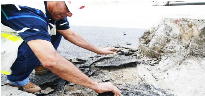
Figura 7. Agrietamiento de las vías recién pavimentadas de Chiclayo
