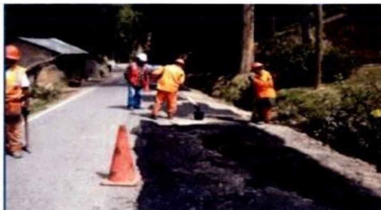
Figura 23: condición de la estructura del pavimento dañado superficialmente
