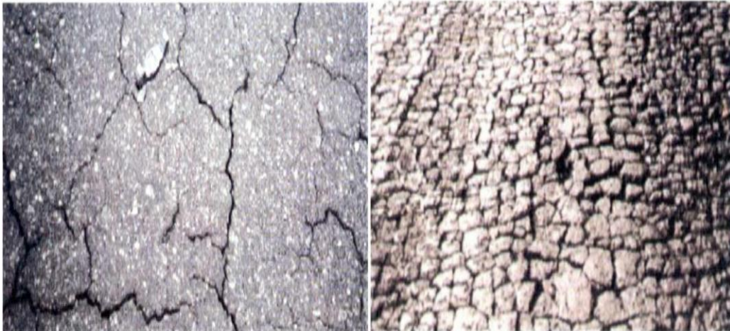
Figura 11 : Corresponde a una serie de fisuras interconectadas con patrones irregulares
