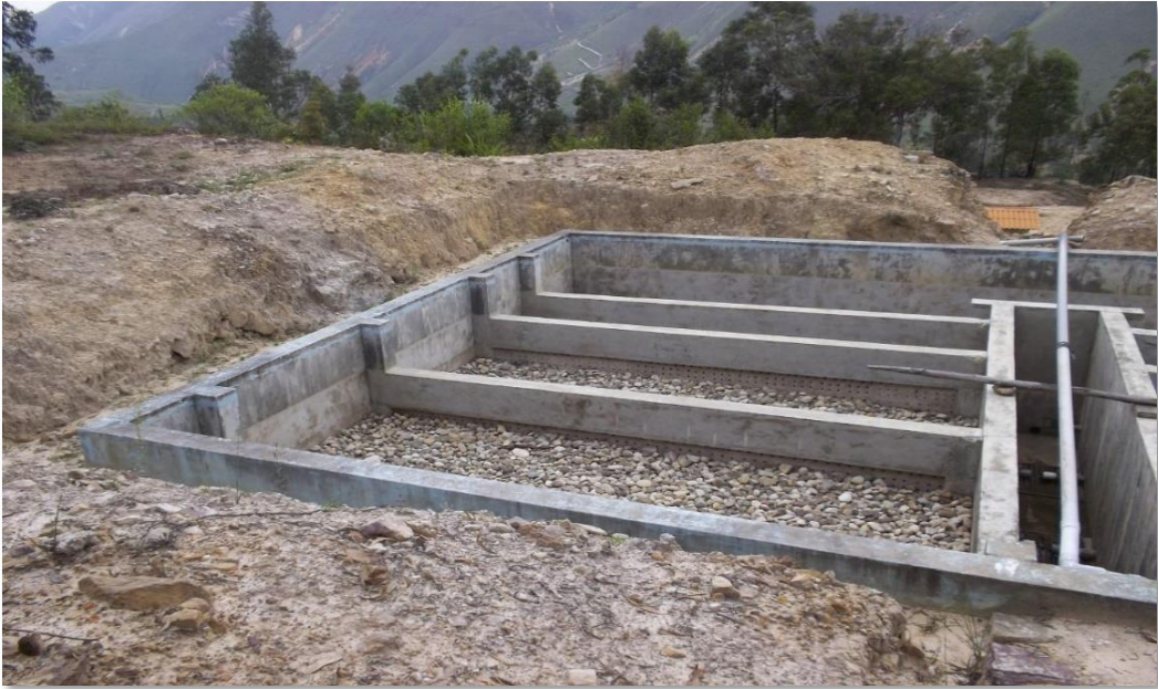
Figura 15. Pre-filtro colapsado, debido a sentamientos en su fundación.
