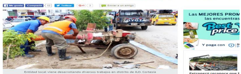
Figura 24 Intervención de EPSEL frente a colapsos en José Leonardo Ortiz.
