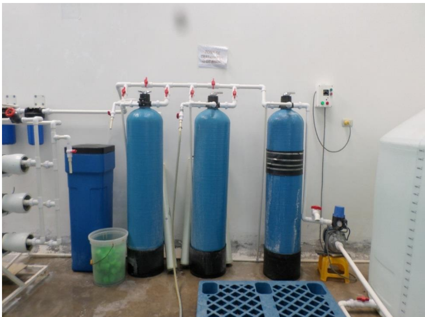
Figura 26: Zona de tratamiento de agua
