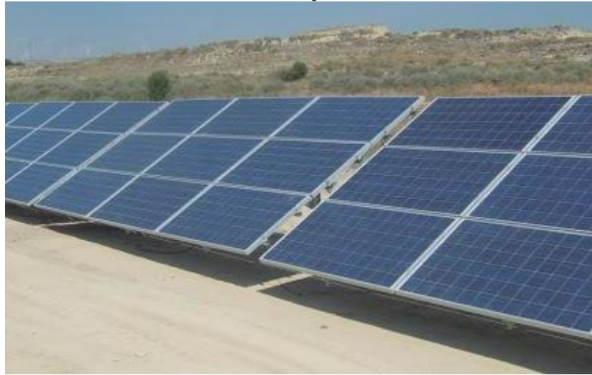
Figura 12: Módulos Fotovoltaicos con estructuras fijas en suelo
