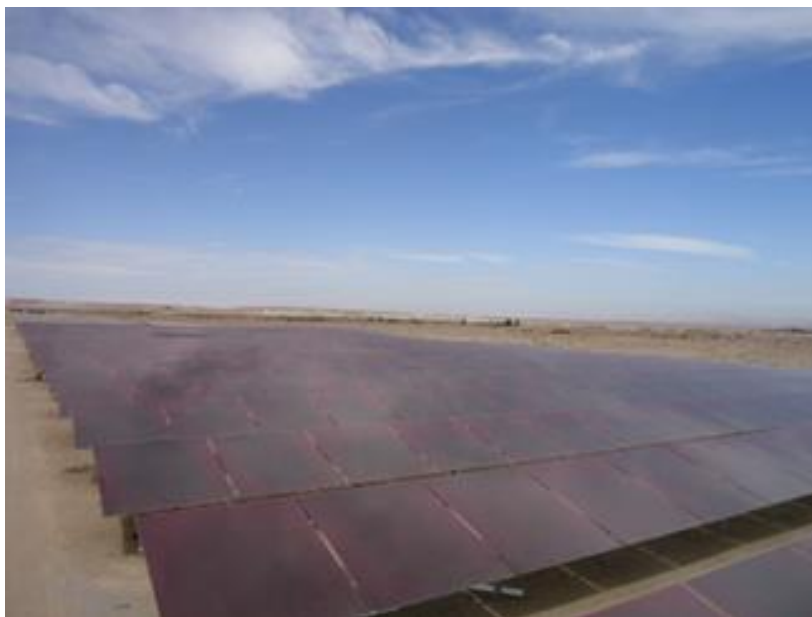
Figura 2: Central Solar Fotovoltaica Repartición de 20MW, ubicado en La Joya, Arequipa
