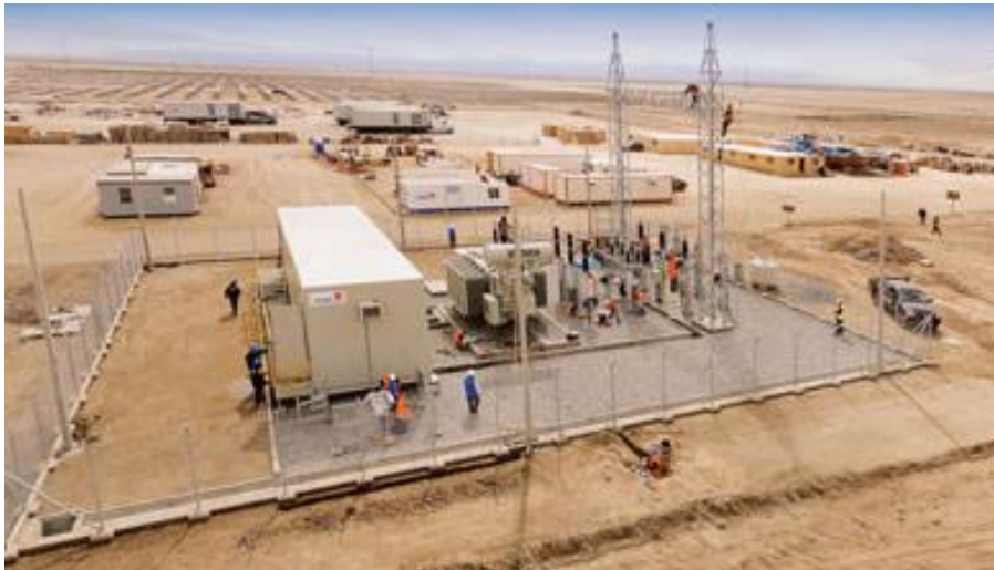
Figura 7: Subestación Elevadora de la Central Solar Tacna de 20MW, en Tacna
