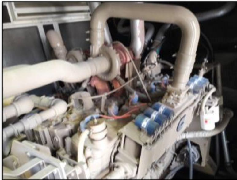
Ilustración 2: Grupo Electrónico del Hospital Regional de Lambayeque.
