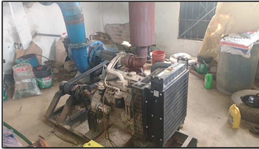
Figura 21: Interior de Caseta de bombeo
