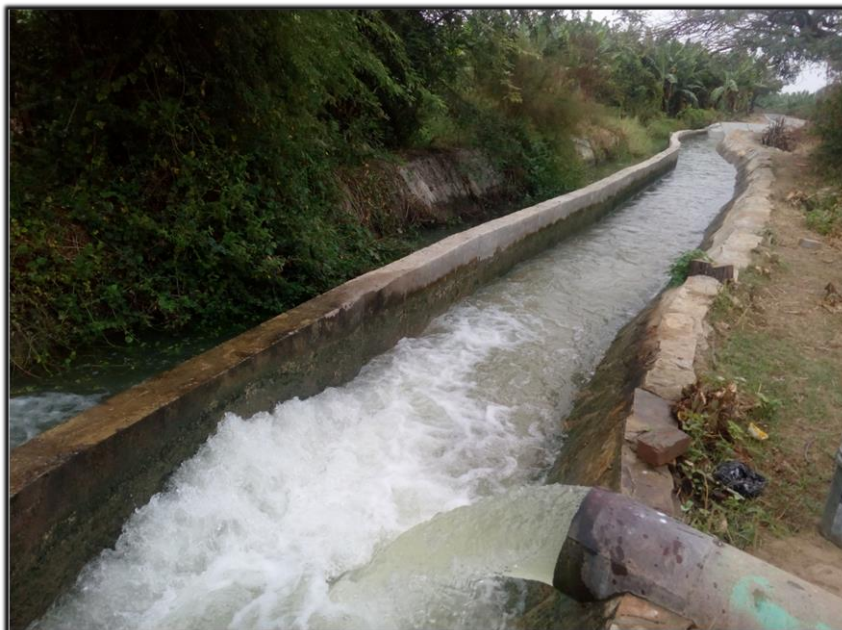
Figura 24: Vista de tubería de Descarga de la caseta de bombeo. Fuente: Caseta de Bombeo de Cooperativa Pequeños Propietarios de Banano Orgánico S.A.
