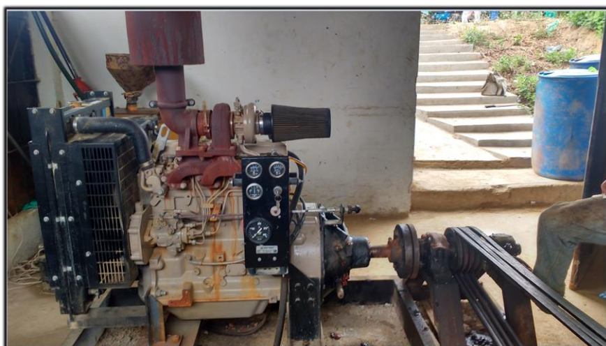
Figura 4: Interior caseta de bombeo con Grupo electrógeno
