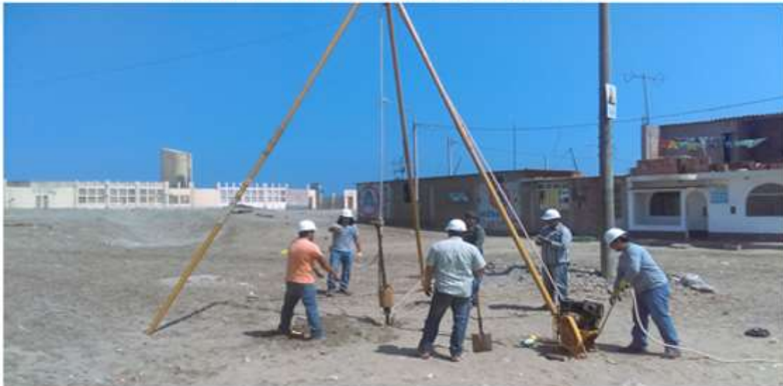
Figura 33: Procedimiento para iniciar el hincado en los primeros 15 cm en el SPT-1 Fuente: Propia
