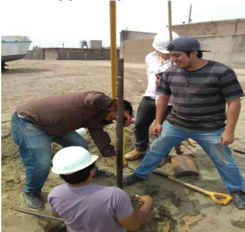
Figura 35: Demarcación de la caña para mantener una referencia al momento de iniciar el hincado en el SPT-5 Fuente: Propia
