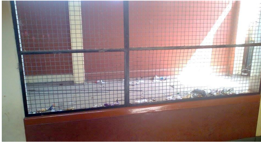
Figura N°03: Leyenda Acumulación de basura en diversos espacios que podrían afectar a la salud de los niños y docentes.
