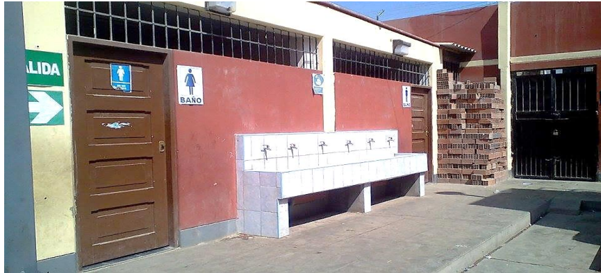
Figura N°01: Leyenda Antiguos baños de la I.E.P, que actualmente se encuentran en desuso debido a la falta de mantenimiento y a la apertura de nuevos SS.HH. En la parte posterior se aprecia material de construcción (ladrillos) los cuales ponen en riesgo a cualquier integrante de la Institución.
