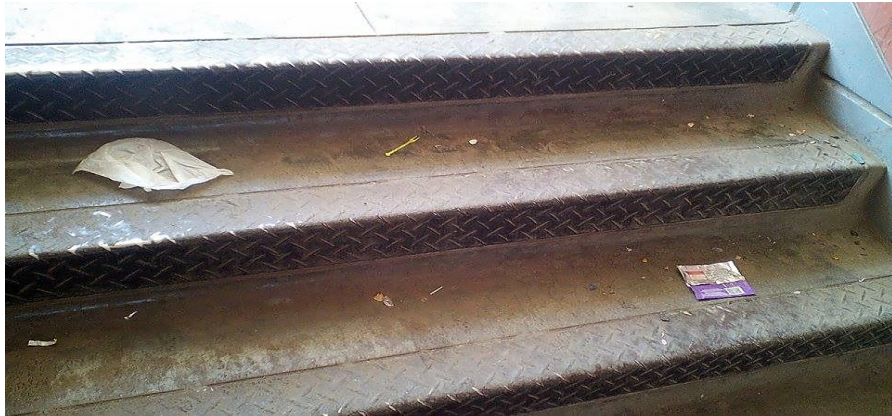
Figura N°05: Leyenda Acumulación de basura en las escaleras y diversas áreas.
