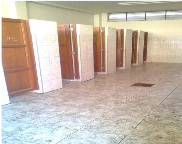
Figura N° 02: Leyenda El piso de los servicios higiénicos que son actualmente utilizados por la población estudiantil se encontraba sucio.
