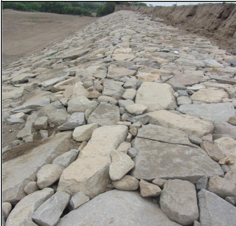
Figura 8: Defensa ribereña a los márgenes del puente
