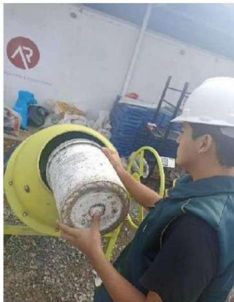
Incorporación de agregados al trompo para la realización de la mezcla de concreto con adición de ceniza
