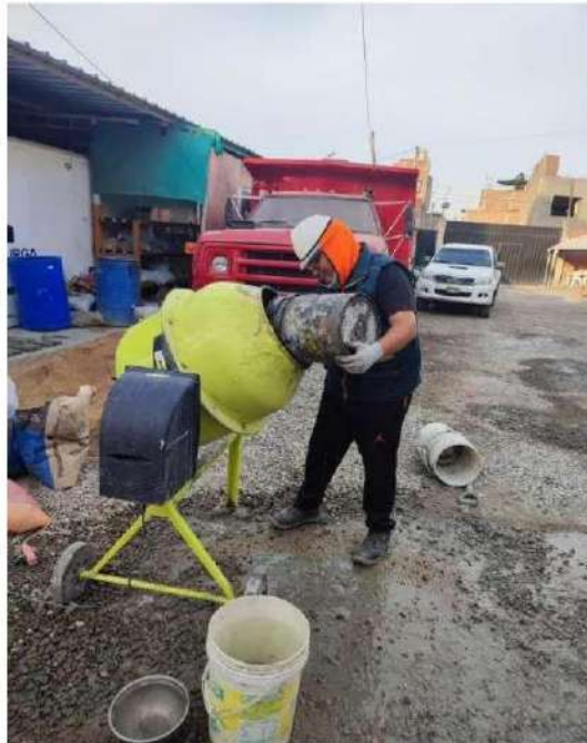
Incorporación de agregado fino al trompo para la realización de concreto con fibra de polipropileno
