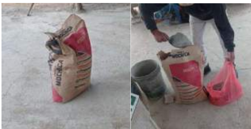
Fig. 13. Evidencia – Tipo de cemento
