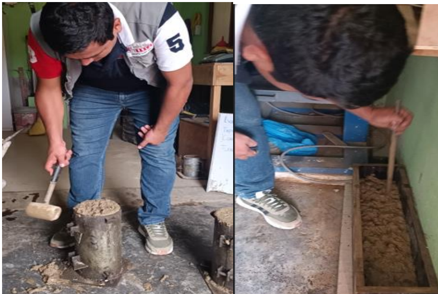
Fotografía 8. Encofrado de las muestras de concreto en las probetas cilíndricas y viguetas rectangulares
