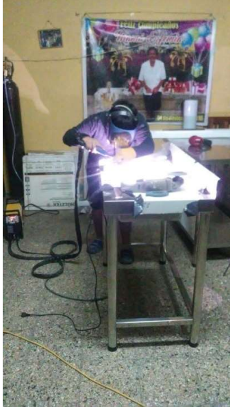
Foto 1 Soldador no haciendo uso de EPP
