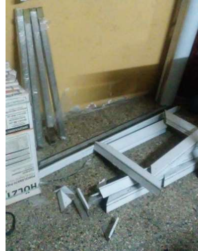
Foto 2 Incorrecto almacenamiento del material
