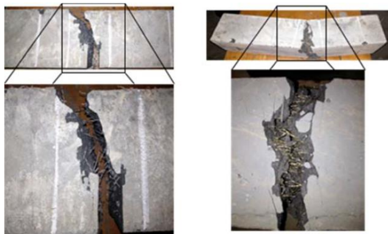
Fig. 14. Modos de falla por flexión en vigas fibroreforzadas con acero. [50]
