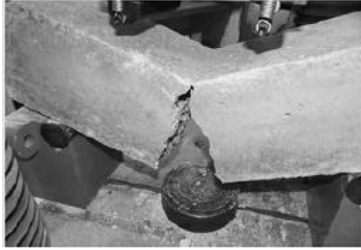
Fig. 7. Falla por flexión en una viga de concreto. [44]
