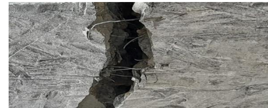
Fig. 84. Puente de fibra de acero en la interfaz del concreto. Luego de fallar el espécimen, se le aplicó carga adicional, con el único fin de que se forme una grieta mas pronunciada y así observar el puente de fibra.
