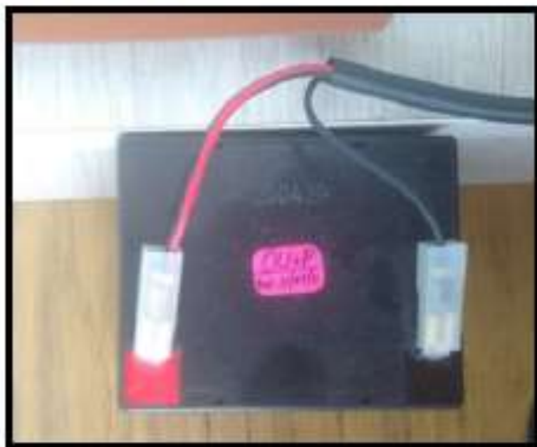
Figura 1. Conexión de batería
